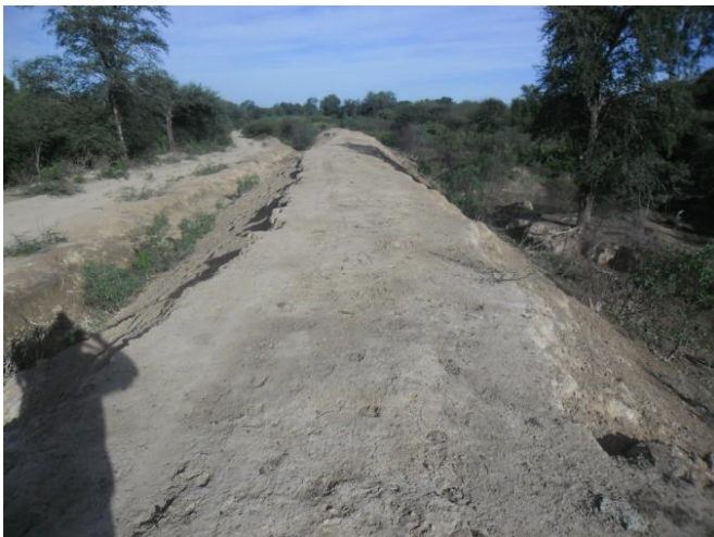
Defensa Misión La Paz Terraplén de defensa zona oeste cercana a la ruta.
